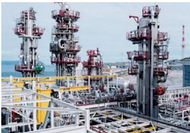
รูปที่ 1 โรงงานอุตสาหกรรมที่ใช้วัสดุหลายอย่างเชื่อมต่อกัน [1]
